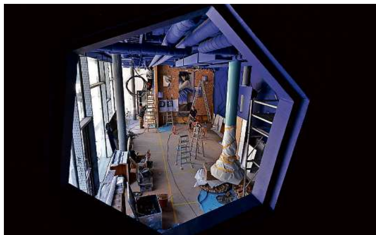
Blick in die Lobby: Noch wird fleissig gearbeitet, wo bald die ersten Gäste des Hotels «The Hide» eintreffen werden. (FOTO JANO FELICE PAJAROLA)
